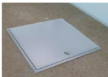
Luukku parvekkeen lattiassa
