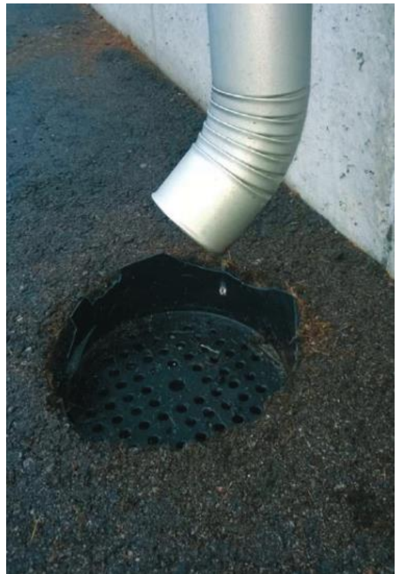
Kuva 2. Muovinen sadevesikaivo rikkoontuu helposti pihaa asfaltoidessa tai kolatessa.
