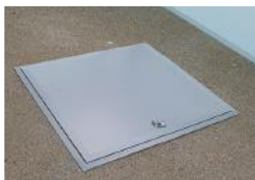
Luukku parvekkeen lattiassa
